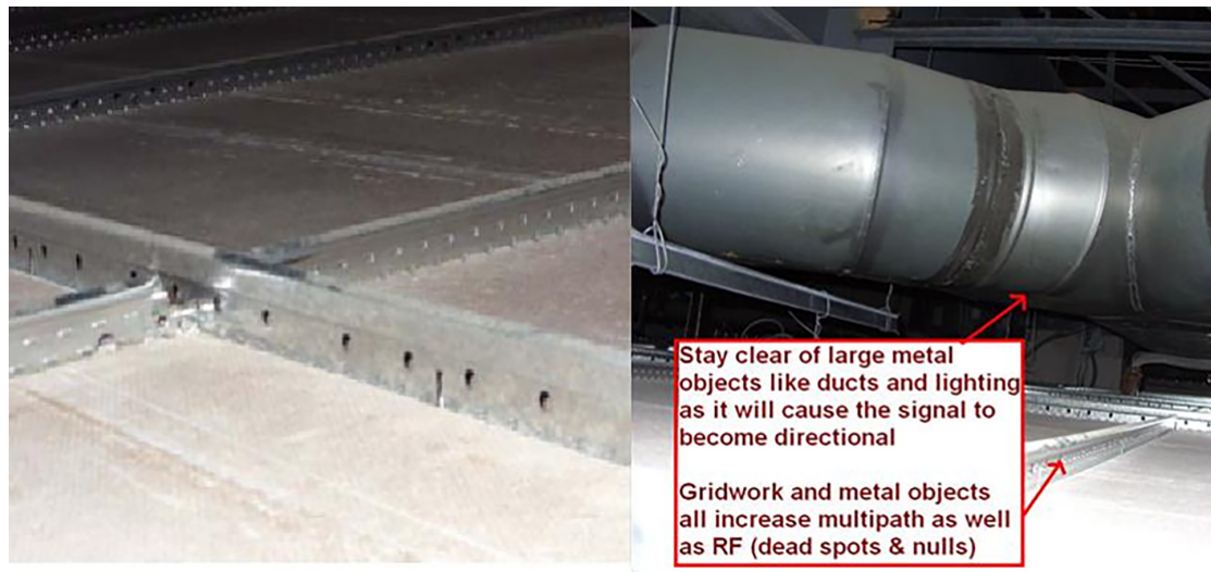
図 15. 天井タイルの上に AP を設置：障害物のない場所を選択し、天井の散乱物を避ける
